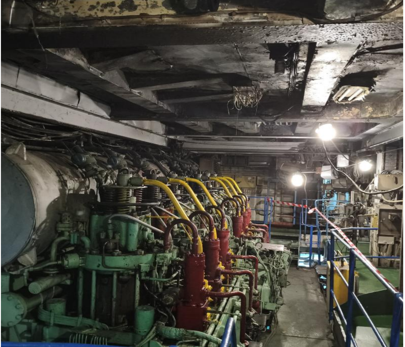
Şəkil 4. Yangından sonra "Merkuri-1" gəmisinin baş mühərrik bölümü.
