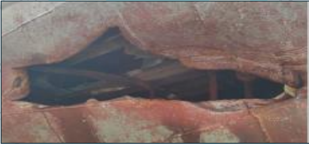
Şəkil 1 PS 173 Zədələnmiş sualtı hissəsi
